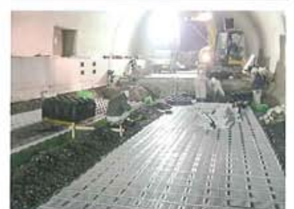
隧道内的地下水处理
